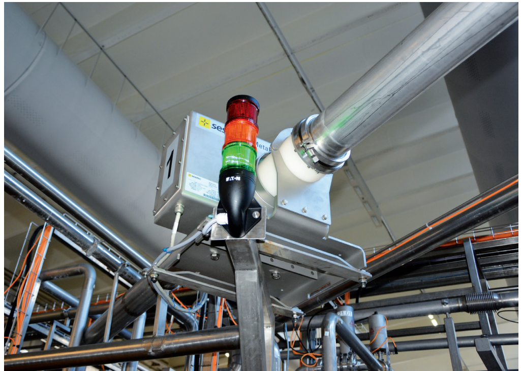
Sesotec Metalldetektor P-SCAN RG eingebaut in eine horizontale Förderleitung
